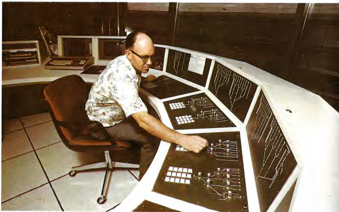
La sala de control de un muelle ferroviario.
