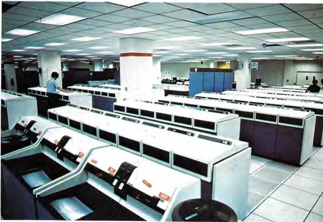
La sección de las unidades de memoria de disco en una sala de máquinas.
