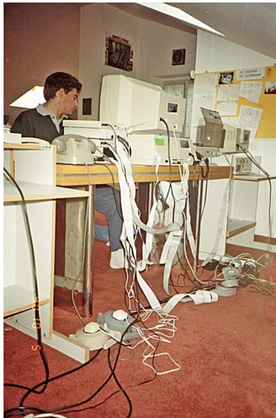
La massa di collegamenti pericolosi. Installai nelle vicinanze 2 estintori!
