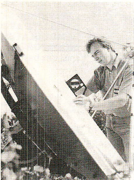
Réglage monture fixe : afin d'obtenir l'indication la plus fiable quant à l'angle d'élévation on applique l'inclinomètre sur une règle coupant verticalement en son milieu le réflecteur recevant en bordure cette dernière.
