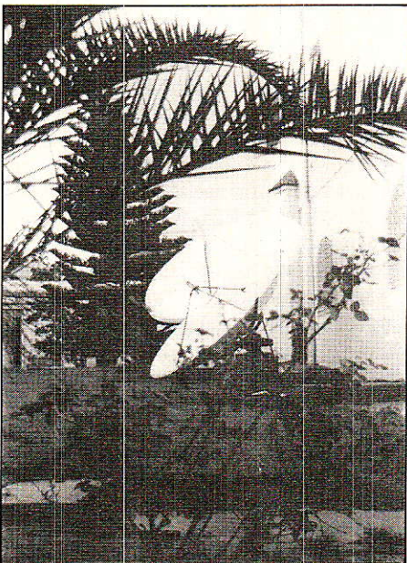
Aménagement d'un site de particulier... dans le sud tunisien. Au premier plan une antenne de 2,40 m pour la réception d'EUTELSAT 1 F 4 et au second plan une antenne de 3,50 m pour TELECOM 1 C.
