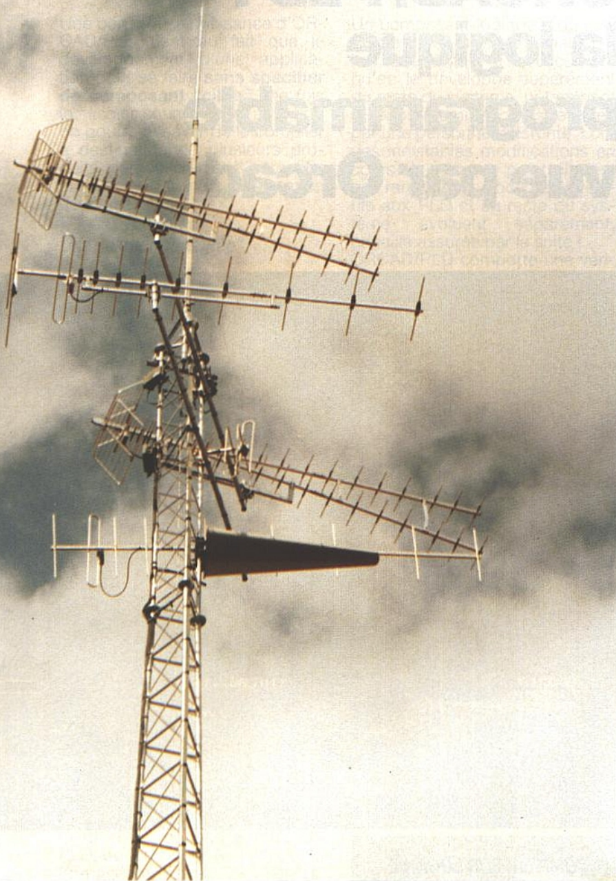
Figure 10 : Le pylône de réception d'une station de tête de réseau câblé (doc. Fuba Communication).
