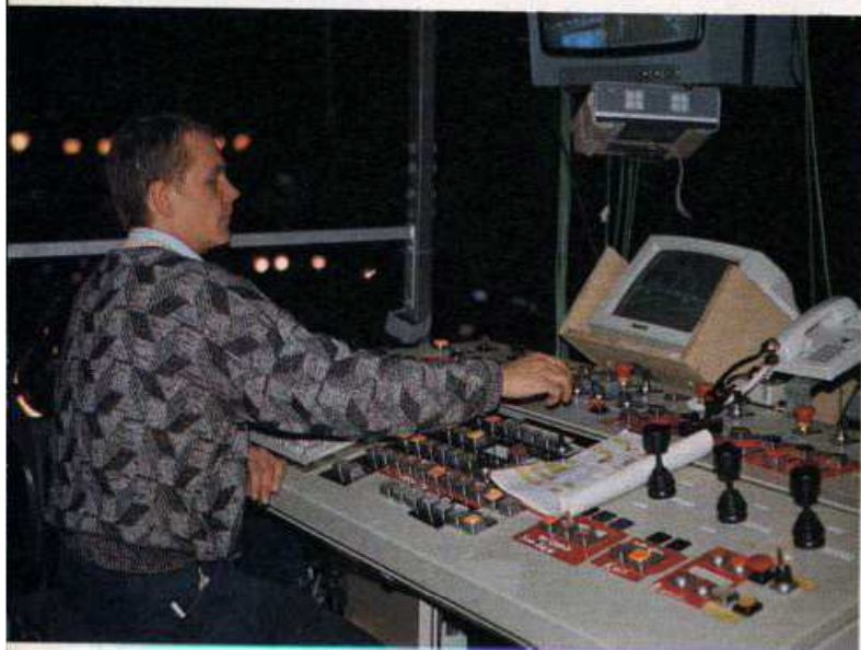
Eines der vielen Kontroll- und Steuerpulte der aufwendigen Licht-Elektronik. Mit den "Joysticks" rechts unten im Bild können die Spots zur Not von Hand gesteuert werden.
