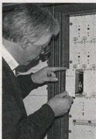
In einem Schaltschrank steckt die gesamte Steuer-elektronik
